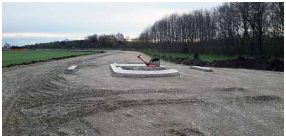
Der Radweg an der LL22 im Bau - die neue Überquerungshilfe ist schon am Entstehen / Foto G. Först
