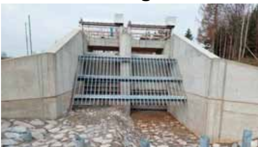
Das aktuelle Bild zum Baustand: Rechts wird später die Singold fließen bei Normalwasser und zusätzlich auch links bei Hochwasser
