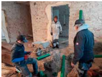
Christoph Micheler, Seniorchef Benedikt Wetzl und Thomas Wunder bei den Umbauarbeiten im Pfarrhof Unterigling
