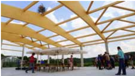
Hier entsteht die neue Gärtnerei-Halle für die Bioland-Gärtnerei von Regens Wagner Holzhausen Foto: Stephan Basener
