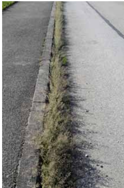
Hier sollte dringend gereinigt werden, da bei Regen kein Wasser abfließen kann
