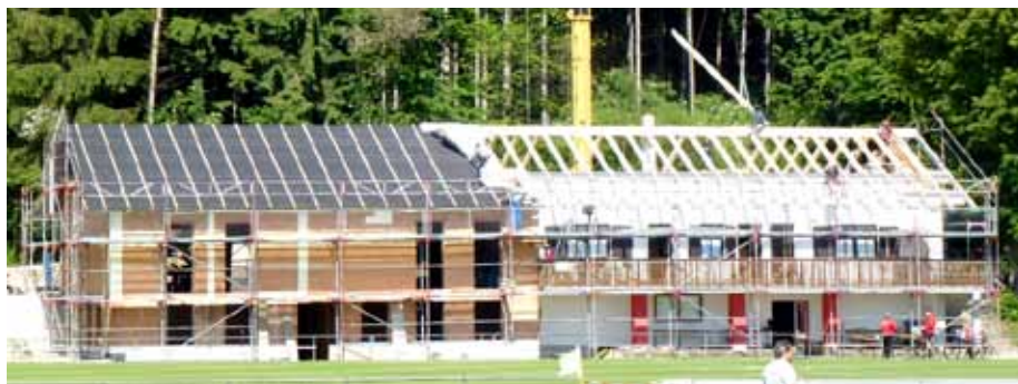
Das neue Schützenheim links und das Sportheim rechts nehmen mehr und mehr Gestalt an. / Fotos: A. Wetzl
