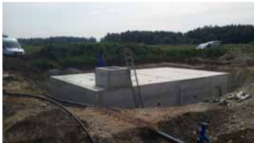
Der eingebaute Löschwasserbehälter
