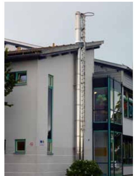
Die Hackschnitzel-Heizung in der Grundschule Igling ist der Knotenpunkt für die neue Nahwärme-Versorgung/ Foto: C. Stede
