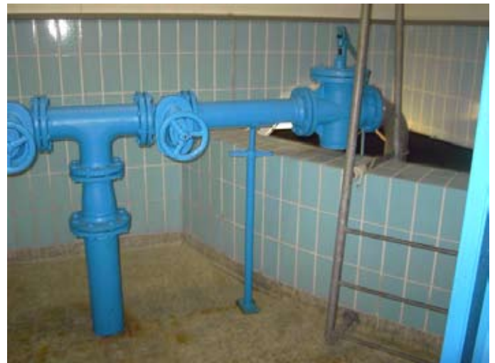
Zulauf im Hochbehälter Holzhausen / Foto: H. Szubert
