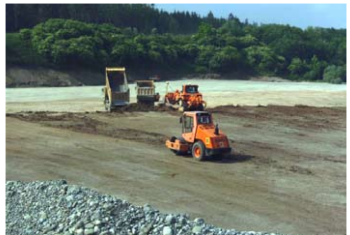
Baumaßnahmen B17 neu bei den Baggerseen zwischen Igling und Kaufering / Fotos: H. Szubert
