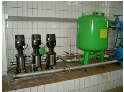
Druckerhöhungsanlage Pumphaus Erpfting Bild: H. Szubert
