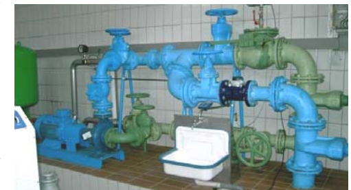
Feuerlöschpumpe im Wasserhaus Erpfting Bericht und Foto: H. Szubert
